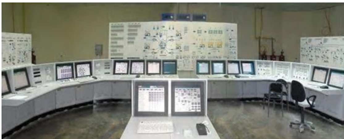
Внешний вид блочного пульта системы верхнего блочного уровня АСУ ТП АЭС
